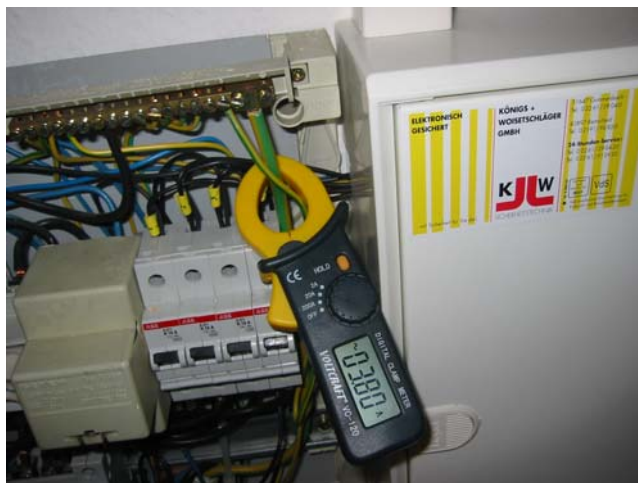
3,8 A in einem EDV-Schaltkasten
