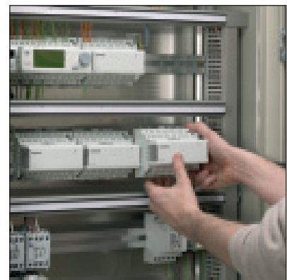
Bild 3. Alle Synco-Geräte haben DIN-35-Format und passen somit in Standard-Schalt-schränke (Siemens)
